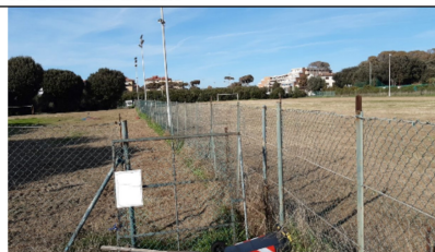
Vista campi da gioco e imp illuminazione entrambi in buone condizioni apparenti, da verificare la funzionalità, quadri el e cavi
