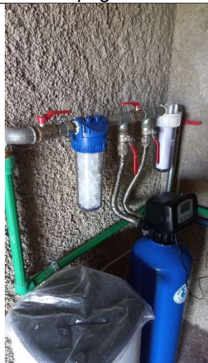
Interni locali tecnici
